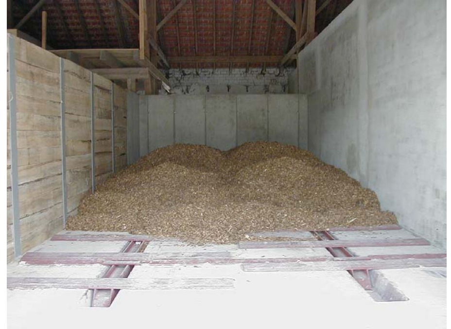
Silo mit Schubboden
